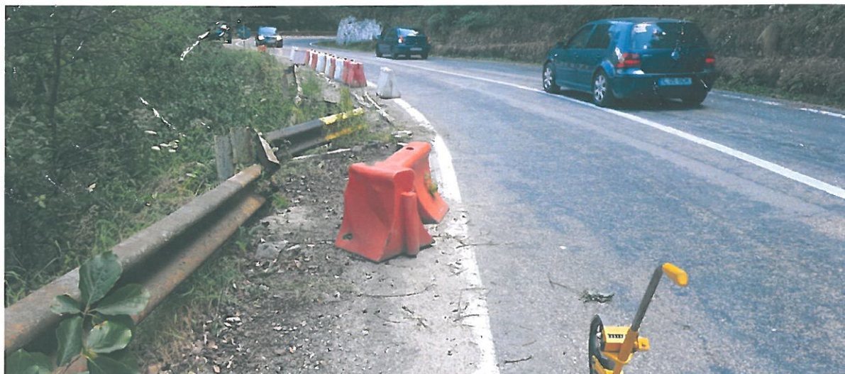
Foto – platforma drumului in zona degradarii
